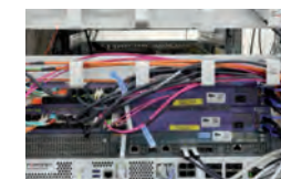
Netzwerkverteiler GS: 63 HS: 65
